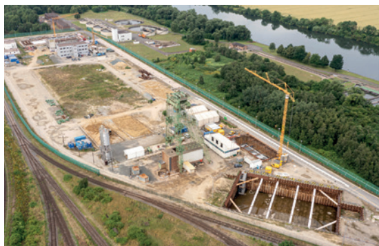
Konrad 2 im Jahr 2021 – Unten Rechts sind die Baugruben von Lüftergebäude und Grubenwasserübergabestation zu sehen. Oben Links wird der Betriebshof errichtet.
