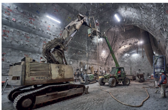
Im Bereich des Füllortes wurden rund 2.950 Gebirgsanker mit einer Länge von bis zu 18 Metern verbaut. Auch Injektionen wurden zur Verfestigung des Gebirges vorgenommen (Bild).
